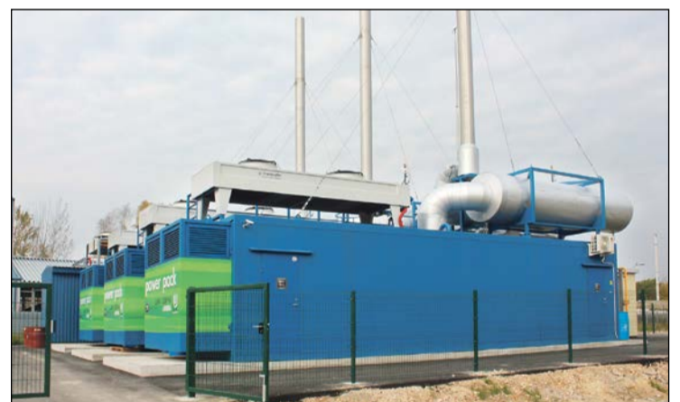
Jaunuzceltā koģenerācijas stacija Olainē, Celtnieku ielā 3
